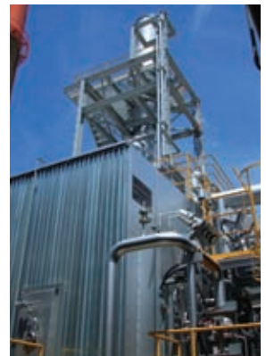
▲No.2号ボイラー
