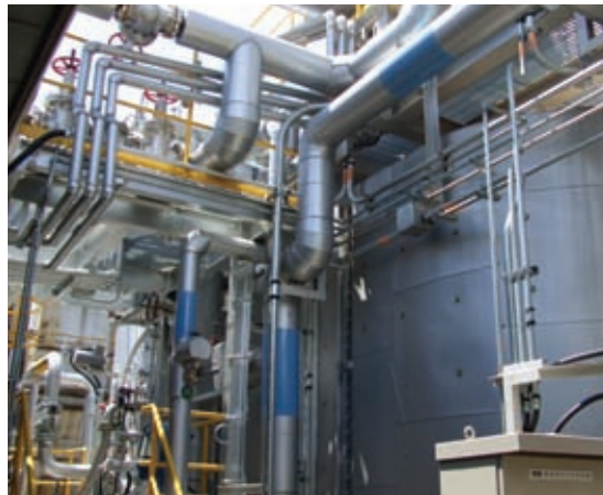
▲ No.2号ボイラー
