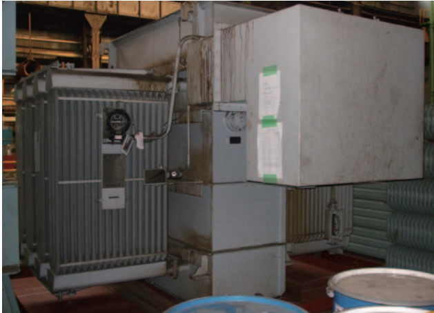
PCBを含有するトランス
