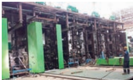
5基連続冷間圧延機
